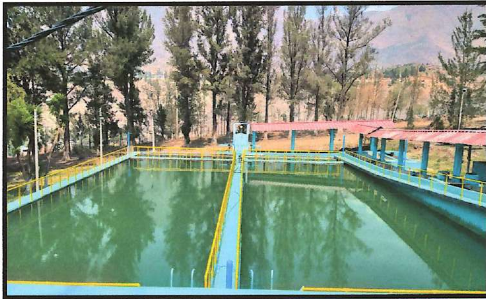
VISTA FOTOGRÁFICA N° 4: Decantador Planta N° 1
