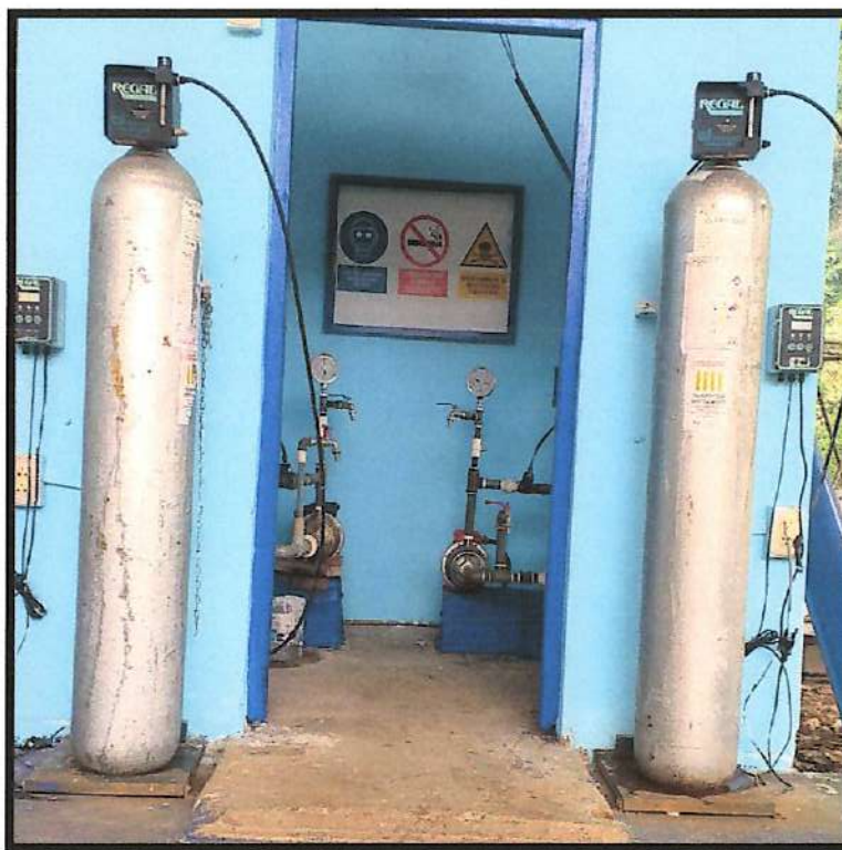
VISTA FOTOGRÁFICA N° 22: Equipo de Clorinación de Caisson N° 2
