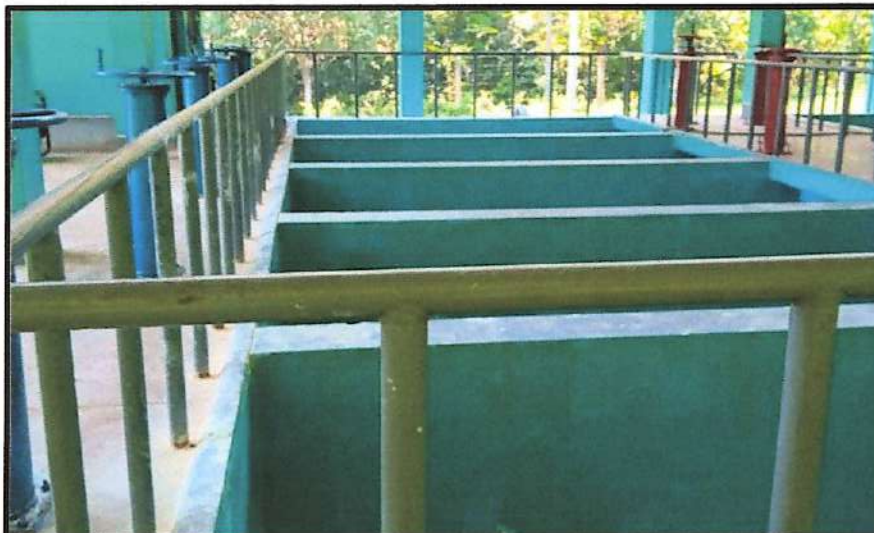
VISTA FOTOGRÁFICA N° 32: Filtros
