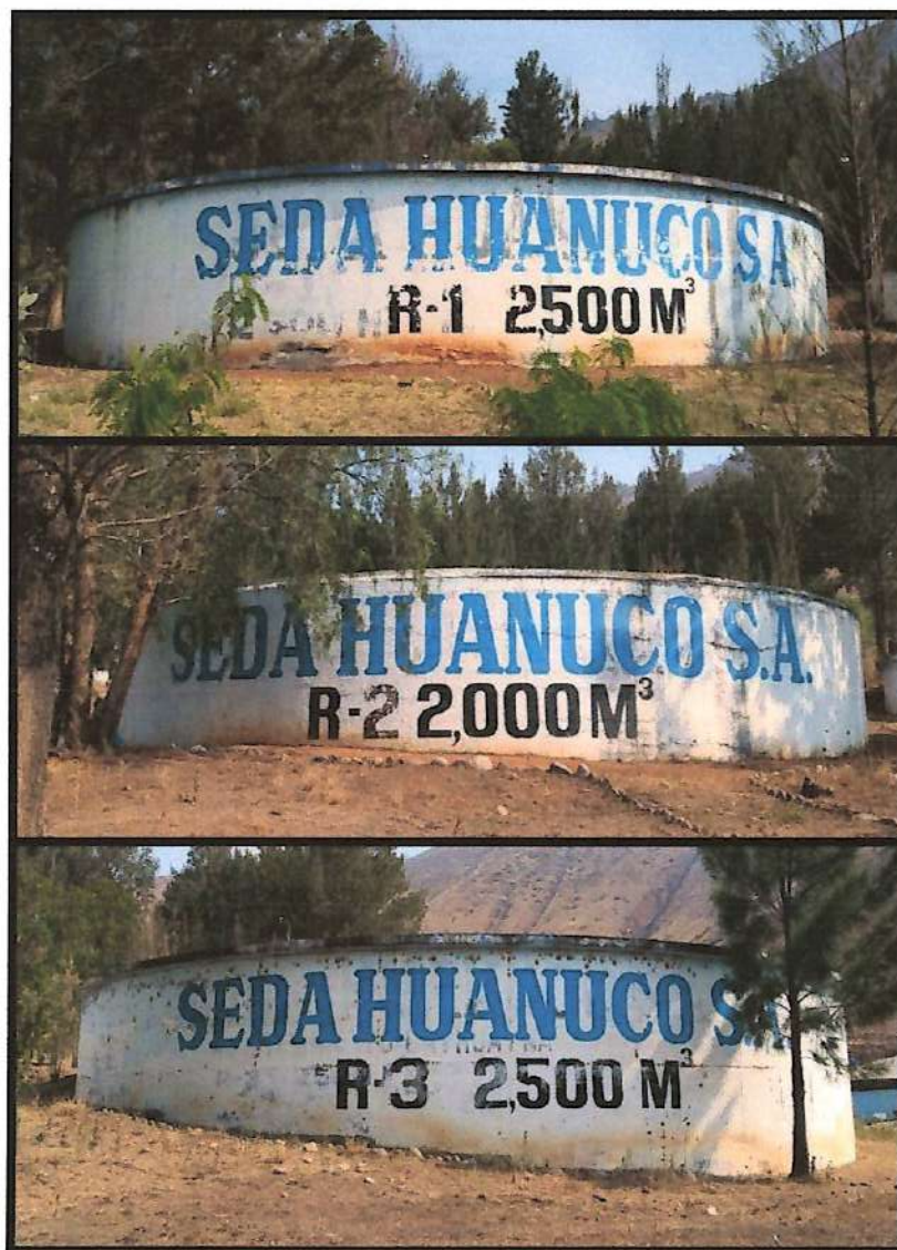
VISTA FOTOGRÁFICA N° 12: Reservorios en la PTAP
