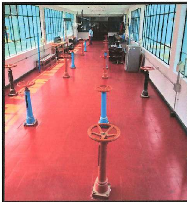
VISTA FOTOGRÁFICA N° 10: Sala de Mandos
