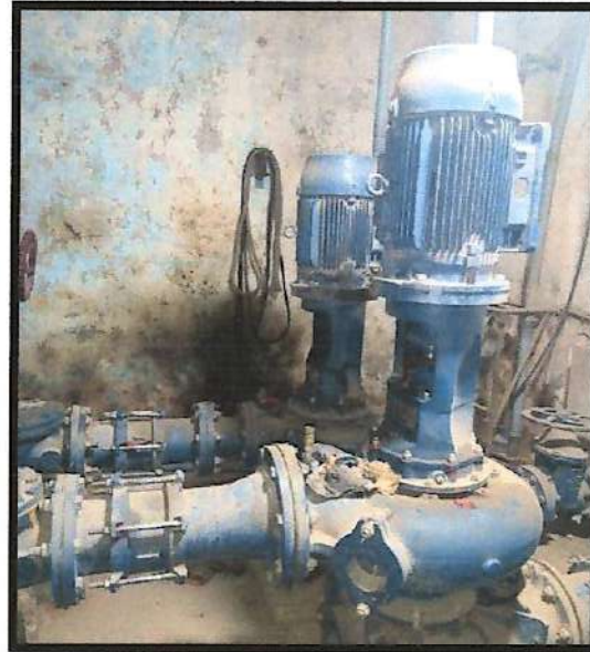
VISTA FOTOGRÁFICA N° 37: Estación de Bombeo
