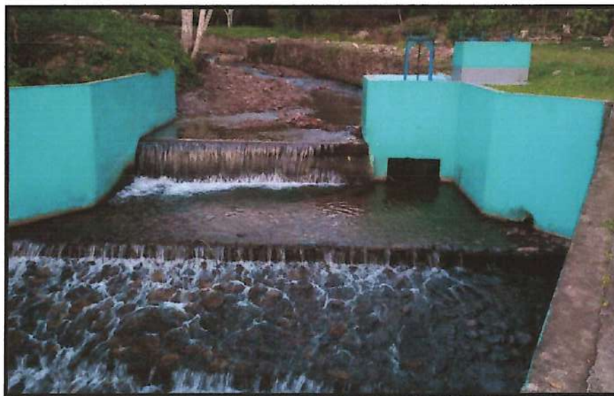
VISTA FOTOGRÁFICA N° 23: Bocatoma de Captación en el río Tigre
