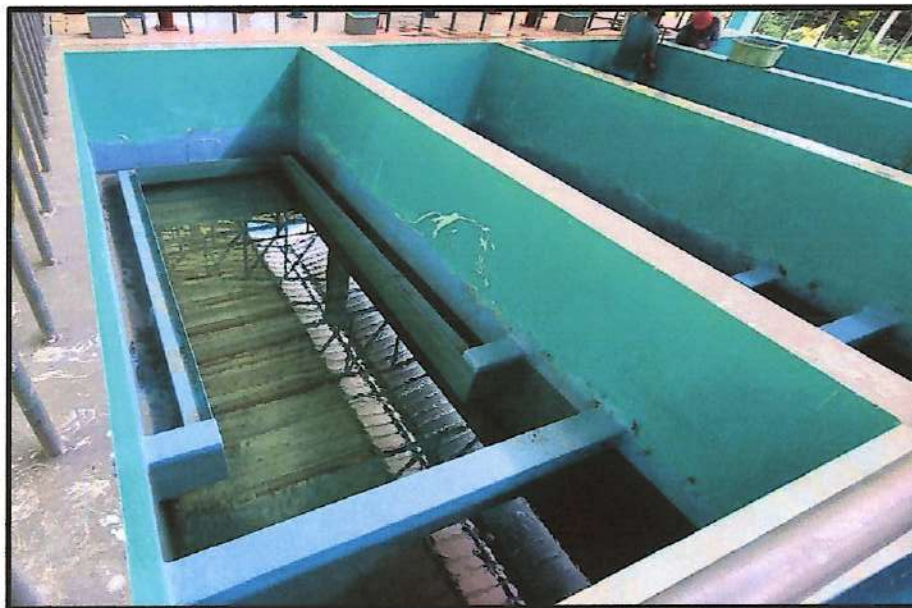
VISTA FOTOGRÁFICA N° 31: Sedimentador con placas laminares
