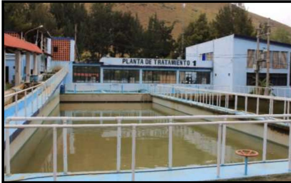
IMAGEN N° 2: PLANTA DE TRATAMIENTO 1
